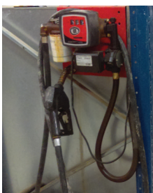
Cuve munie d'un volumètre (remplis- sage au hangar)
